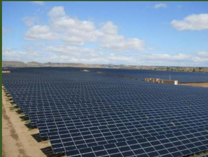
Méga installations de panneaux photovoltaïques
