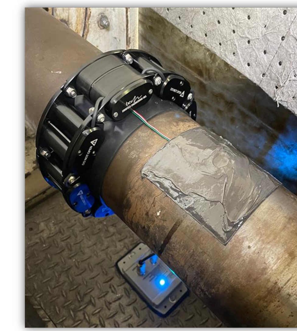
Couplemètre installé sur un arbre de sortie de moteur
