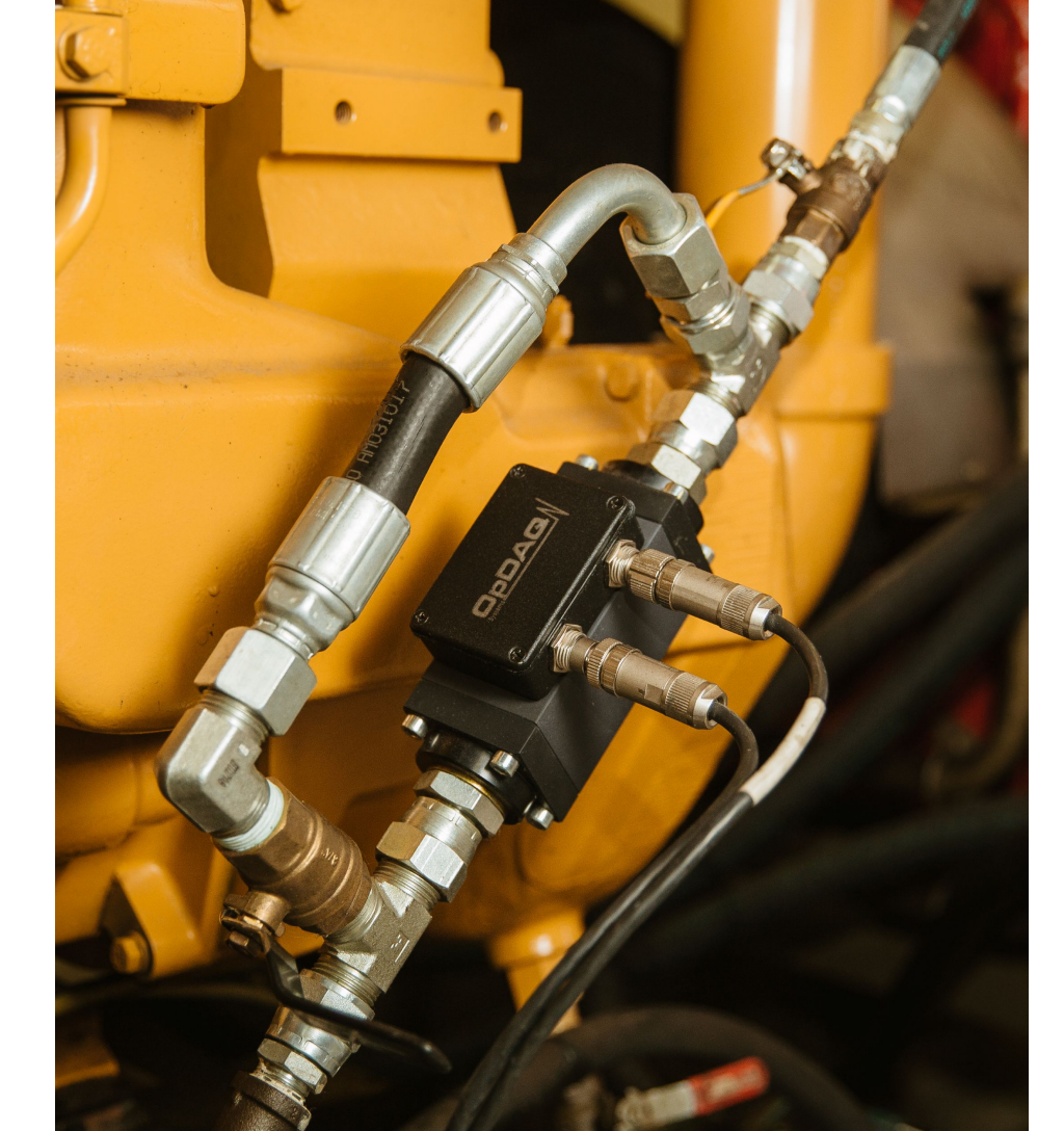
Débitmètre installé sur l'alimentation en carburant
